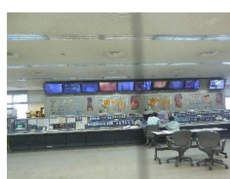
第 2 工場の中央制御室
