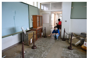
4階・浸水の高さがわかる
