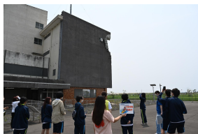
津波被害の4階外側
